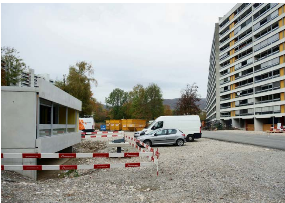
Auf dem Werkplatz gegenüber dem Gebäude B steht ein Mockup der Westfassade.
