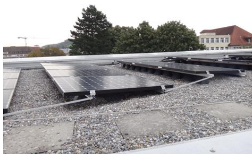
04M_Pestalozzi_NABLenzburg (4608x3456 Pixel) Photovoltaikmodule auf dem Dach
